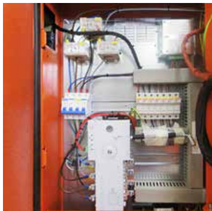
ATS IN (знаходиться всередині електричного щита генератора)
