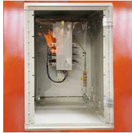
ATS OUT - localizado exteriormente al generador
