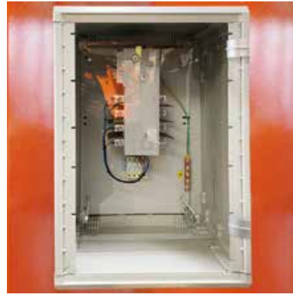
QTC OUT - localizado externamente ao gerador
