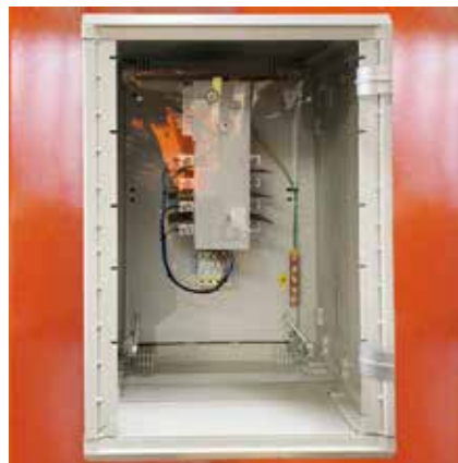
ATS OUT (знаходиться зовні генератора)
