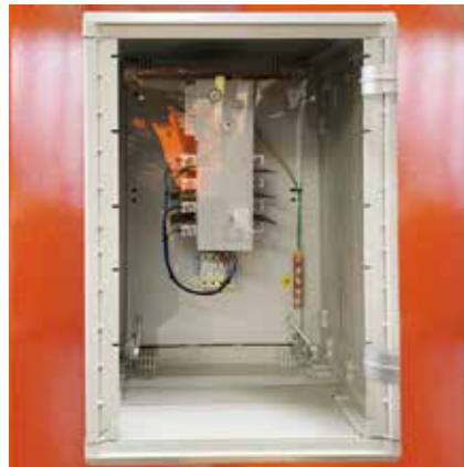
ATS OUT - localizado exteriormente al generador
