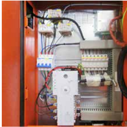
QTC IN - localizado no interior do quadro elétrico do gerador
