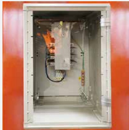
QTC OUT - localizado externamente ao gerador
