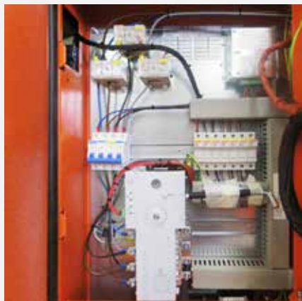
ATS IN - localisé à l'intérieur du tableau électrique du groupe électrogène
