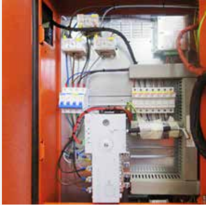
ATS IN - localizado en el interior del cuadro eléctrico del generador
