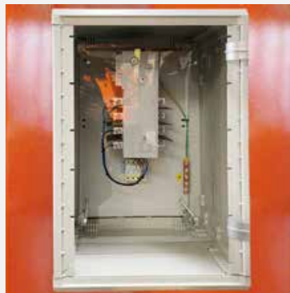
ATS OUT (знаходиться зовні генератора)
