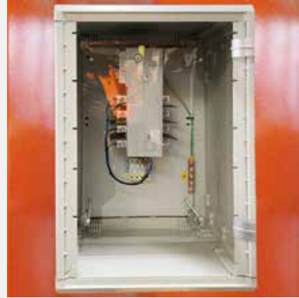
ATS OUT - localizado exteriormente al generador
